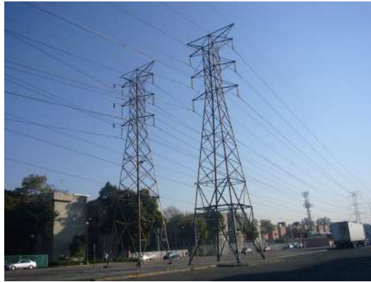
Torre de electricidad
